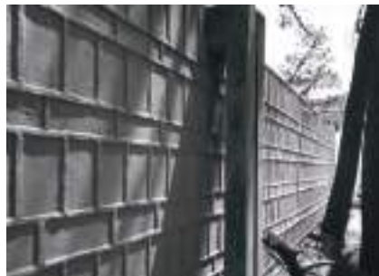
Une des gouttières qui conduit la pluie de la toiture plate jusqu'au sol Source: Clément-Gaillard
